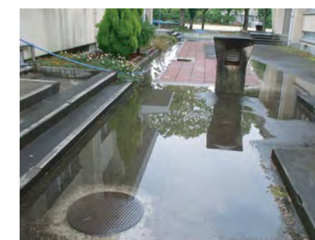
敷地内の排水が悪い状況
