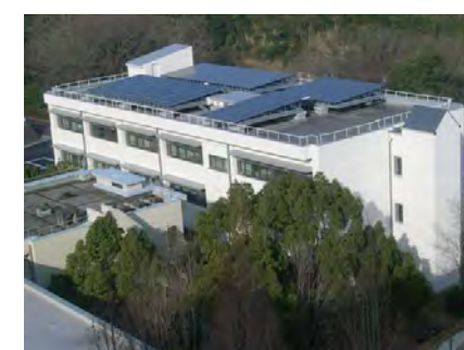
太陽光発電システム
