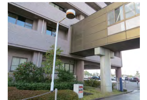
老朽化した外灯
