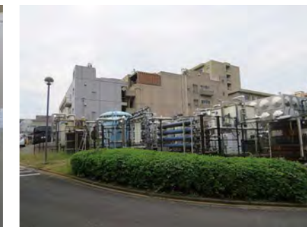
地下水活用システム
