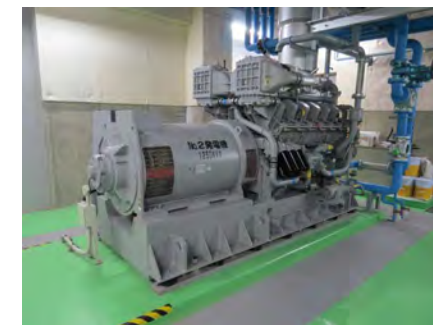
自家発電設備
