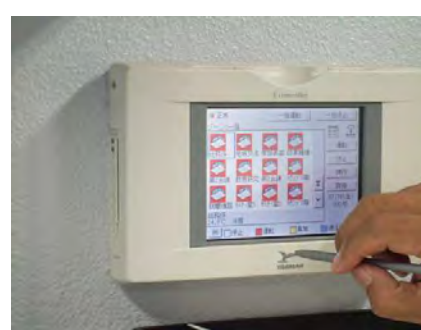
運転監視システム
